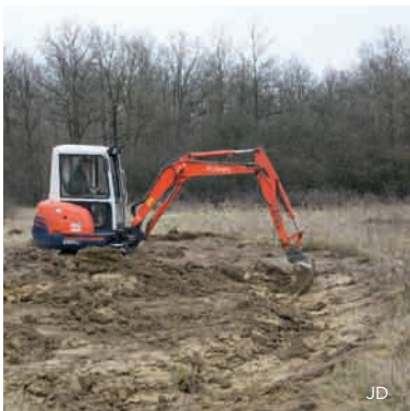
Creusement d'une mare à pentes douces sur sol argileux en vue de favoriser les amphibiens
