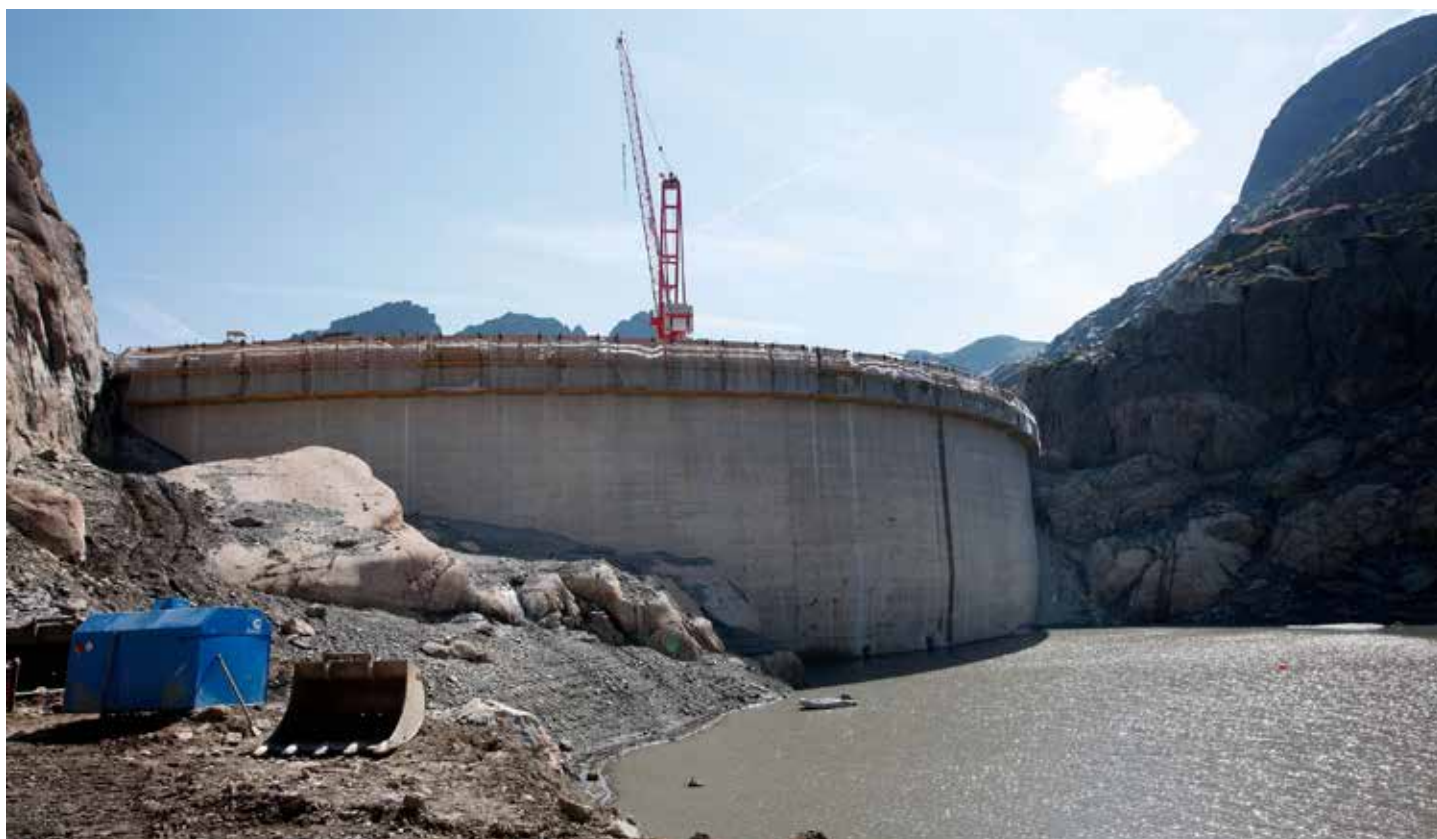
Surélévation du barrage de Vieux-Emosson, dans le cadre de la construction du nouvel aménagement de pompage-turbinage de Nant de Drance.
